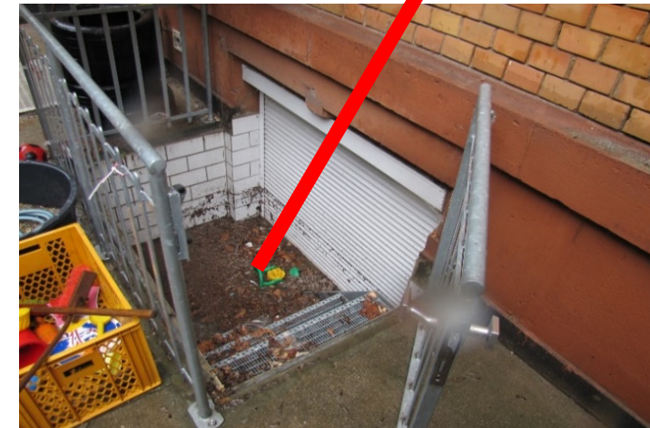
Abb.: Überflutung einer Kita im August 2020; wie durch die SRGK prognostiziert, ist das Wasser durch einen ebenerdigen Lichtschacht eingedrungen (Stadt Heidelberg 2020)
